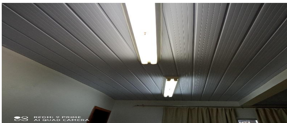
Figura 17 – Pintura interna e substituição de cantoneiras de PVS e forro de PVC danificado, troca de luminária;
