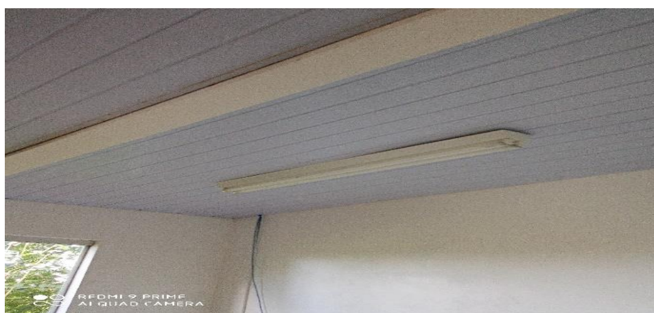
Figura 16 – Pintura interna e substituição de cantoneiras de PVS e forro de PVC danificado, troca de luminária;
