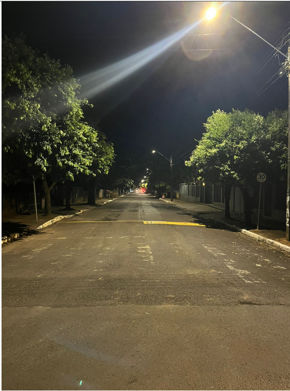
F27 – Luminárias de LED instaladas na Rua Evaristo Castelani (noite)
