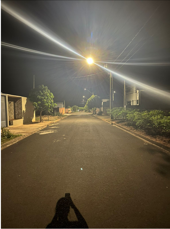
F03 – Luminárias de LED instaladas na Rua Antônio Batista dos Santos (noite)
