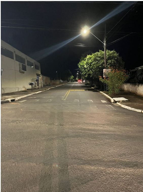
F25 – Luminárias de LED instaladas na Rua Inácio Francisco dos Santos (noite)
