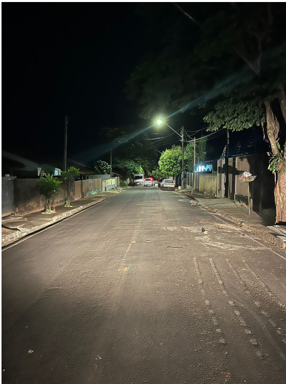
F21 – Luminárias de LED instaladas na Rua Pedro Papa (noite)
