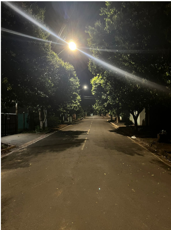
F17 – Luminárias de LED instaladas na Rua Valdemar Menegassi (noite)
