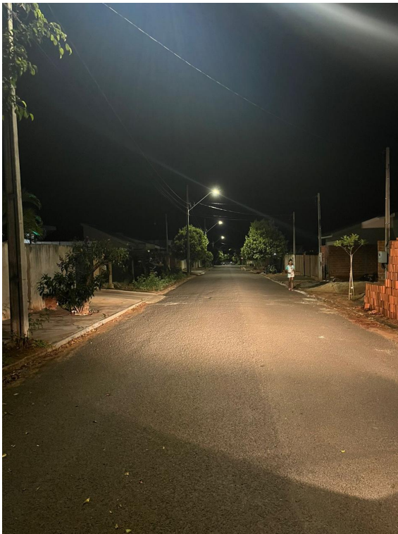
F05 – Luminárias de LED instaladas na Rua Antônio Benhossi (noite)
