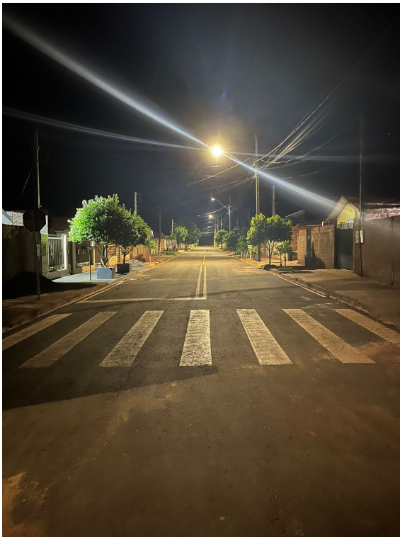
F13 – Luminárias de LED instaladas na Rua José Pitton (noite)
