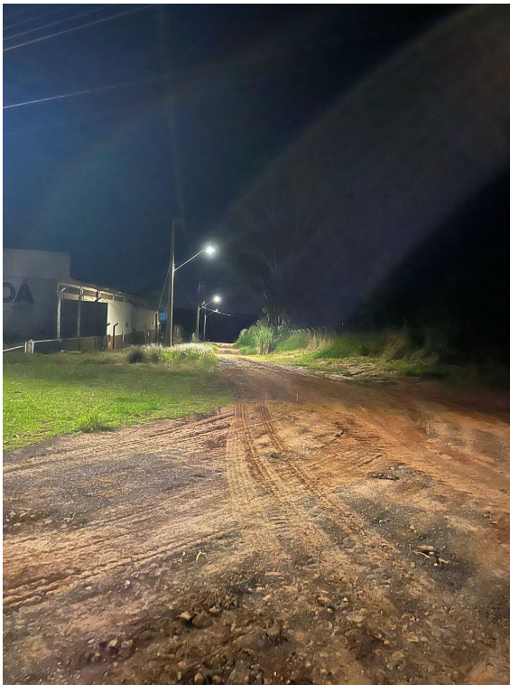
F37 – Luminárias de LED instaladas na Rua Irineu Bernuci (noite)
