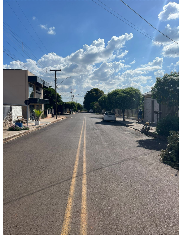
F44 – Luminárias de LED instaladas na Rua Colorado (dia)
