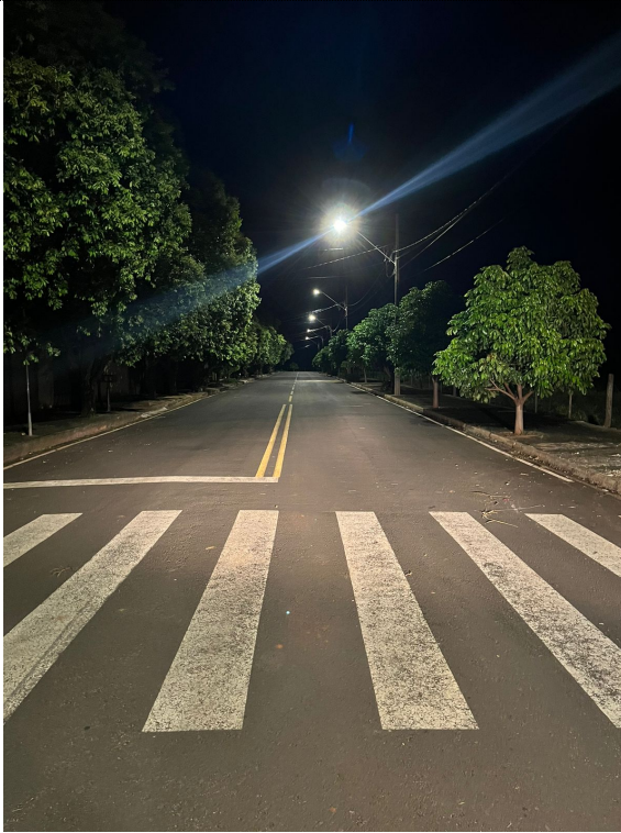
F31 – Luminárias de LED instaladas na Rua Antônio Ciavolella (noite)
