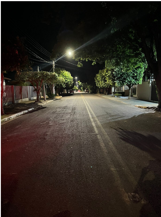
F33 – Luminárias de LED instaladas na Rua São Pedro (noite)
