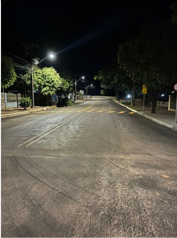
F23 – Luminárias de LED instaladas na Avenida João Giraldi (noite)
