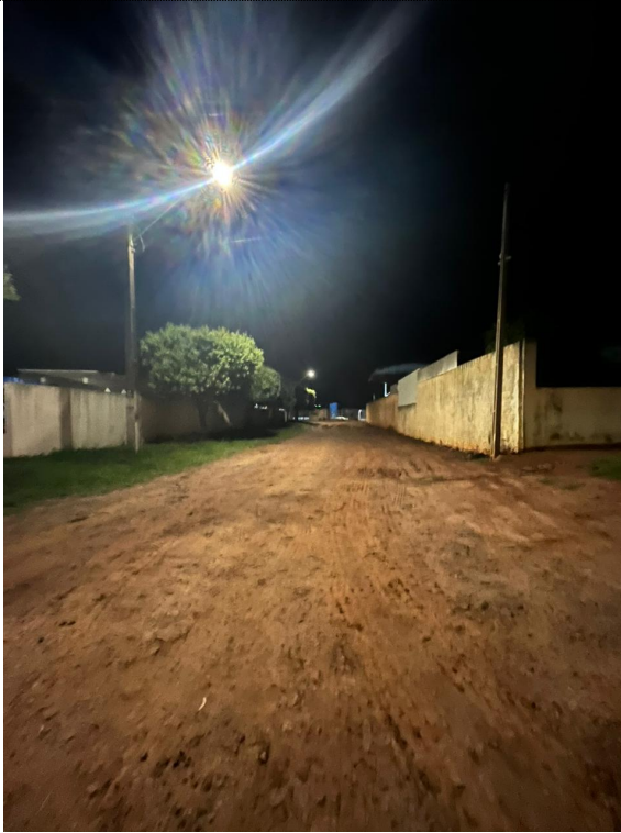
F39 – Luminárias de LED instaladas na Rua Elísio Mendes Barbosa (noite)
