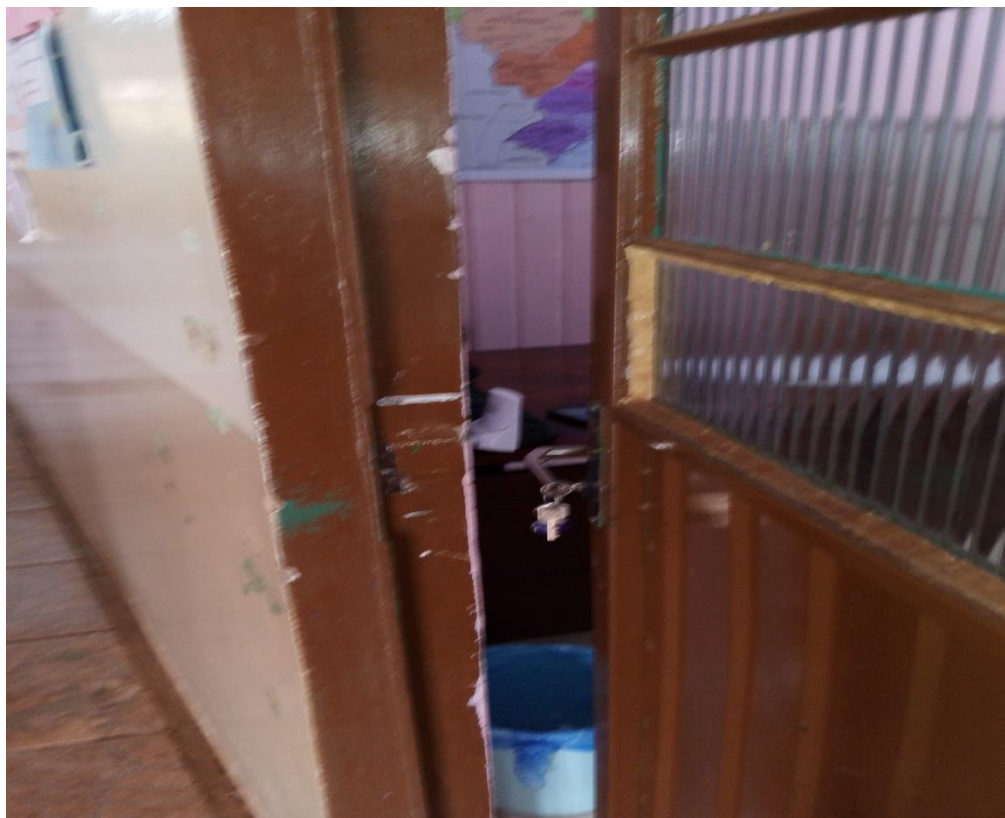
Figura 10 – portas em geral danificadas;
