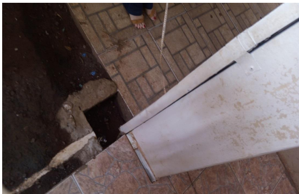
Figura 11 – caixas de passagem precárias;
